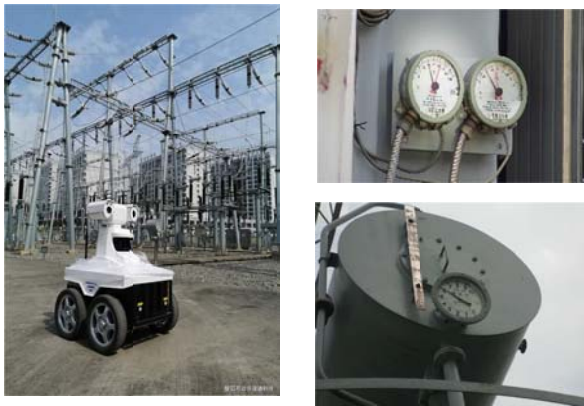
图1 变电站巡检机器人及油温、油位表
