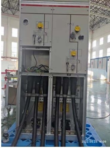
图 1 环网柜温升试验图
