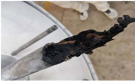
图 8 GIS 绝缘拉杆炸裂故障
