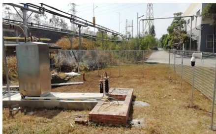
图 13 10 kV小电阻接地系统真型试验场
