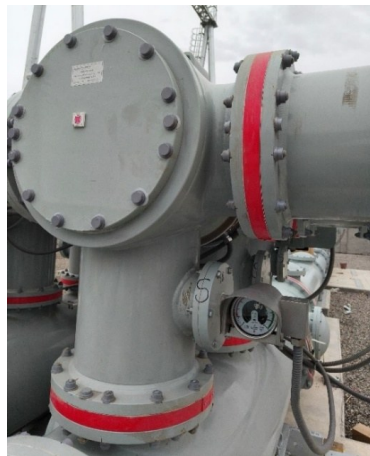
图 1 国网电力甘肃某电场 GIS 设备
