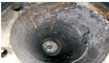
图1 支柱内部受潮情况
