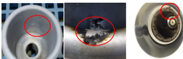
图1 某型号故障滤波器小组断路器灭弧室
