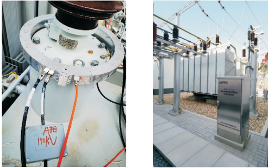
(a) 传感器安装位置 (b) 就地主机柜安装位置
