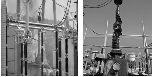
图1 某换流站故障换流变事故照片
