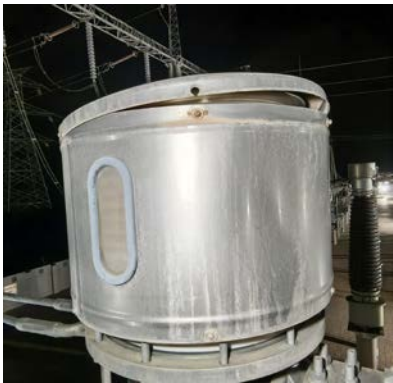
图 2 220 kV 电流互感器 B 波纹膨胀器照片
