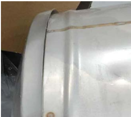
图 1 220 kV 电流互感器 A 波纹膨胀器照片
