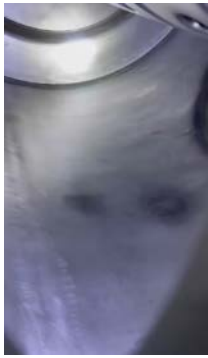
图 14 断路器气室壳体底部黑色痕迹
