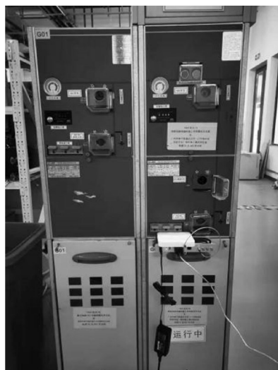
图9 无源无线温度测量系统
