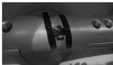
图 2 悬浮电位缺陷
