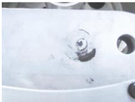
图 15 隔离开关动侧绝缘支撑件支架上残余的 SF 6 气体放电分解产物
