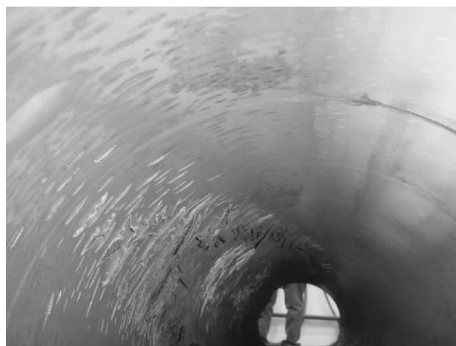
图2 灭弧套管断口处烧蚀照片
