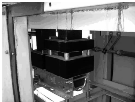
图4 断路器机构箱内CT处
