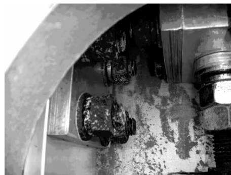
图5 断路器内部受潮情况
