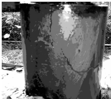
图2 故障相灭弧室
