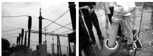
图1 棉湖站揭棉线开关B相受损情况
