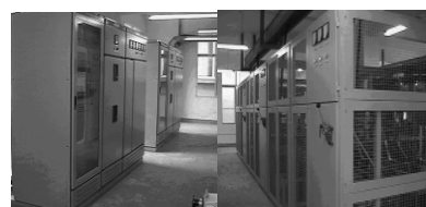
图 8 综合补偿装置现场图
