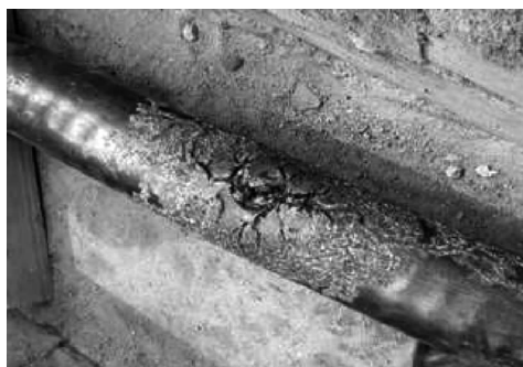
图4 电缆故障点照片
