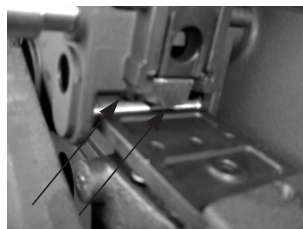
图3 机构箱正面合闸掣子正常位置
