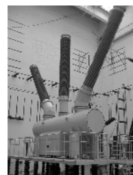
图 3 试验现场的断路器
